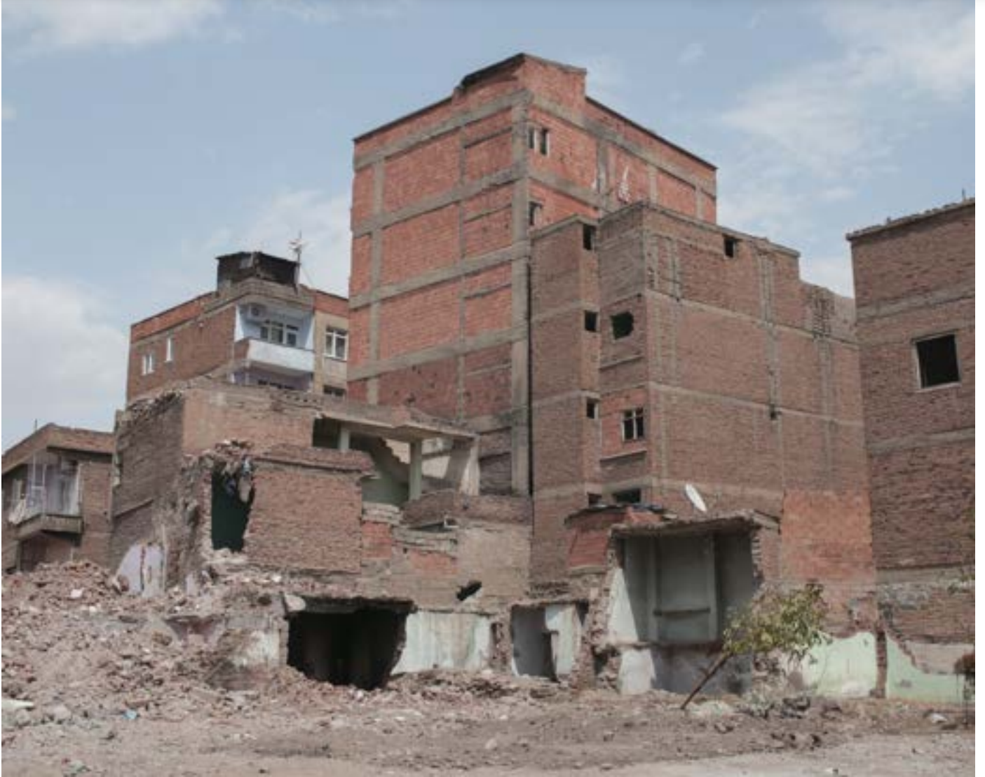
alipaşa mahallesi, yıkımın devam ettiği mahallelerden biri.
